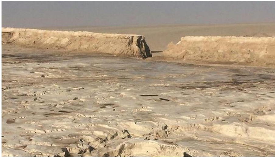
Abbildung 13-12: Dammbruch in der Rotem Gipshalde vom 30.06.2017
